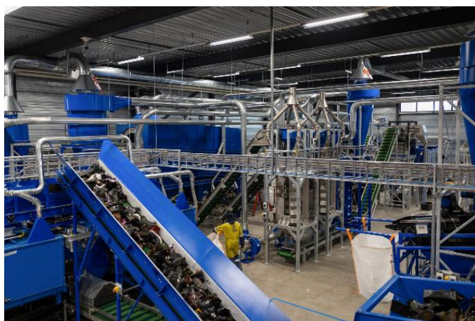
Figure 51 – Ligne de FastFeetGrinded à Heerhugowaard (NL)
